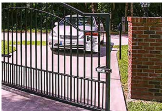
Contrôle de barrières
